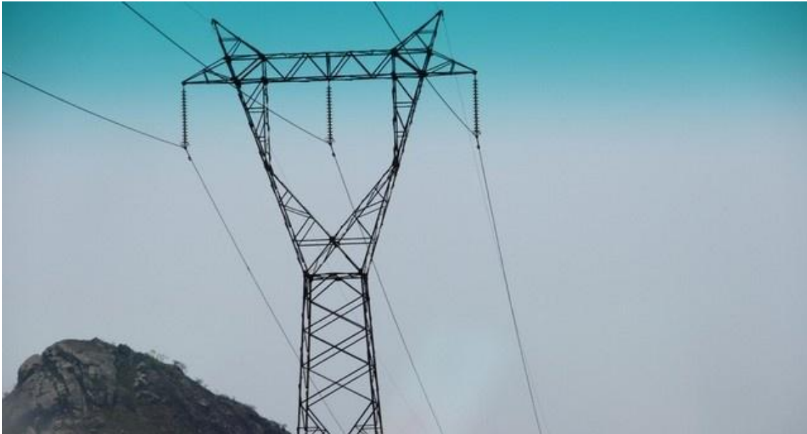
LINHA DE ENERGIA DE ALTA TENSÃO
