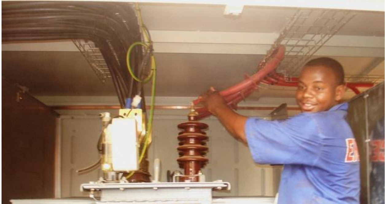
PT de Energia
